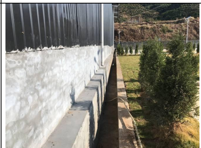
照片 7 木制交易市场周边排水明沟现状
