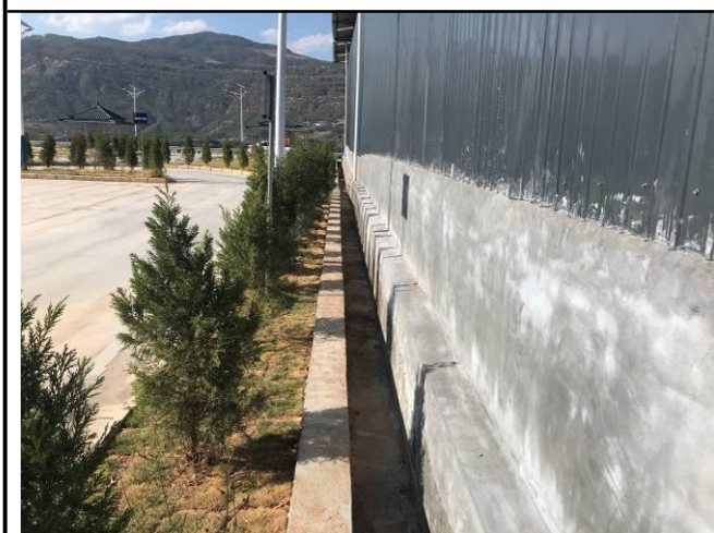
照片 6 木制交易市场周边排水明沟现状
