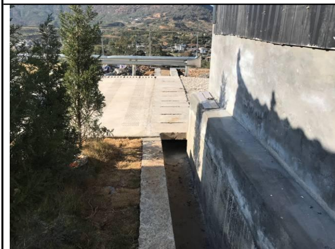
照片 8 木制交易市场周边排水明沟现状
